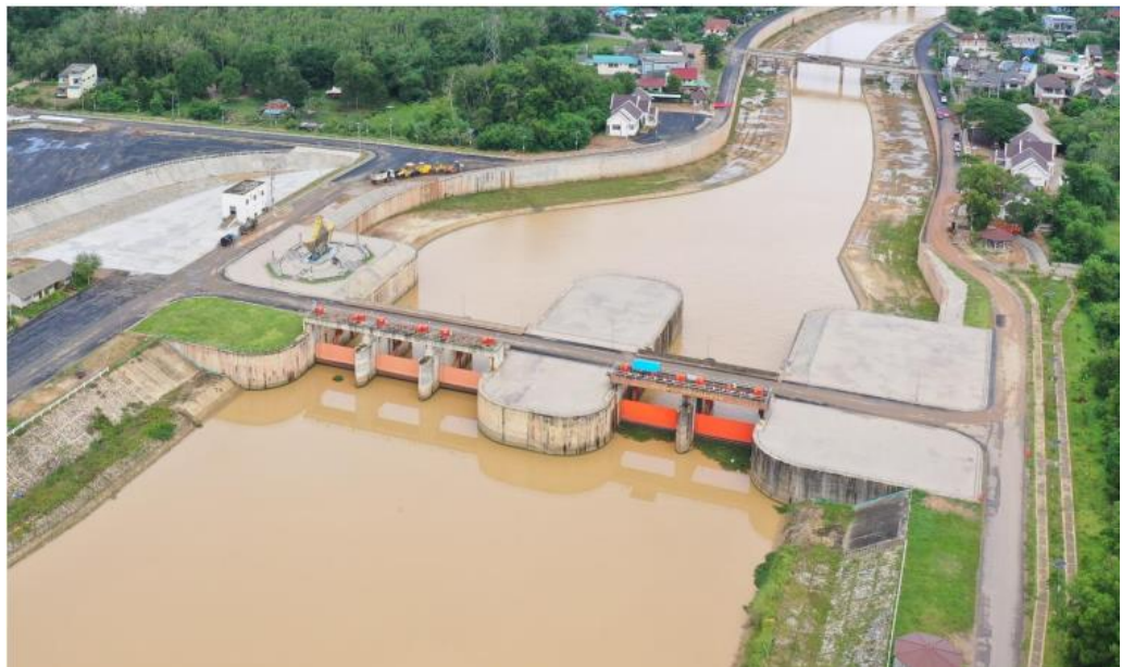
รูปที่ ๓ ก่อสร้างประตูระบายน้ำหน้าควน ๒ ชนิดบานระบายโค้ง จำนวน ๓ ช่อง
